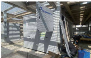
对风冷热泵主机进行维护保养，及时更换易损零配件
